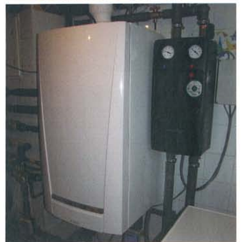
Bei den Pilotprojekten in Pinkafeld und Lieboch kommt bei den eVita-Anlagen ein Freikolben-Stirling-Motor mit Brennwerttechnologie zum Einsatz.
